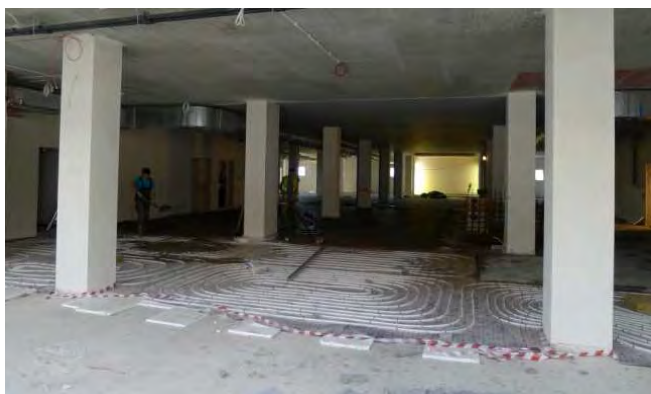
Ogrzewanie podłogowe. Wybrane materiały z realizacji Biblioteki Głównej. PPIP 2010-2012 r. Fot. własne.
